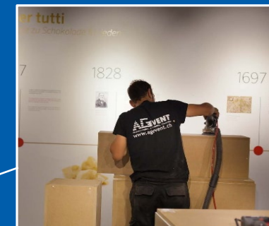
Realizzazione di tutte le strutture e teche, nonché tutti i comparti illuminazione, audio e multimedia.
